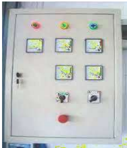
Gambar 2.1 Panel Hubung Bagi
