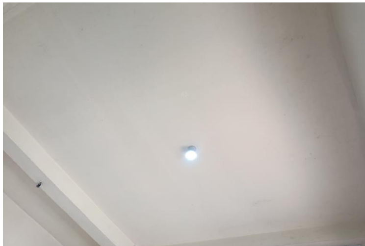
Gambar 4.1 Pencahayaan Ruang Pelayanan Pelanggan dan Administrasi
