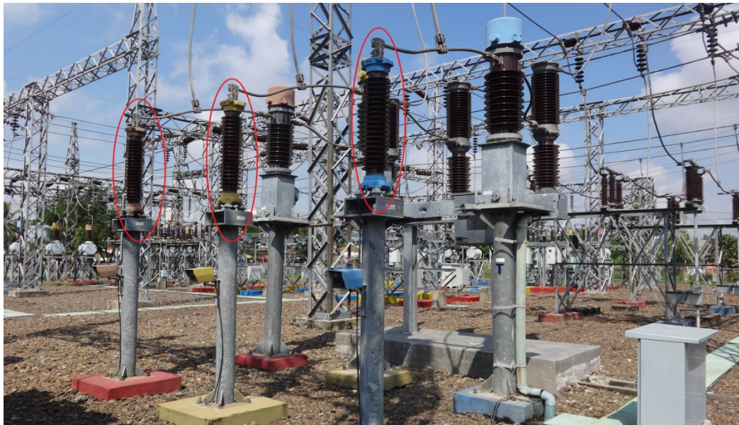
Gambar 2.2 Arrester Pada Gardu Induk Sungai Juara
