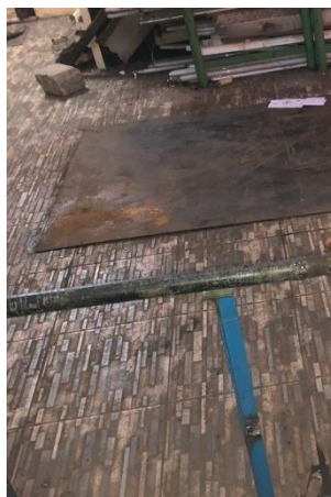
Gambar 2.6 Pipa Saluran Air
