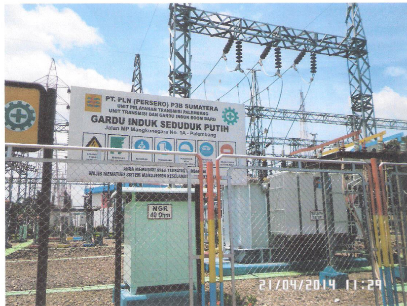
Gambar. Gardu Induk (G.I) Seduduk Putih
