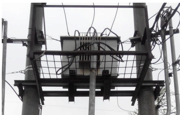
Gambar 2.3 Transformator distribusi pada gardu tiang
