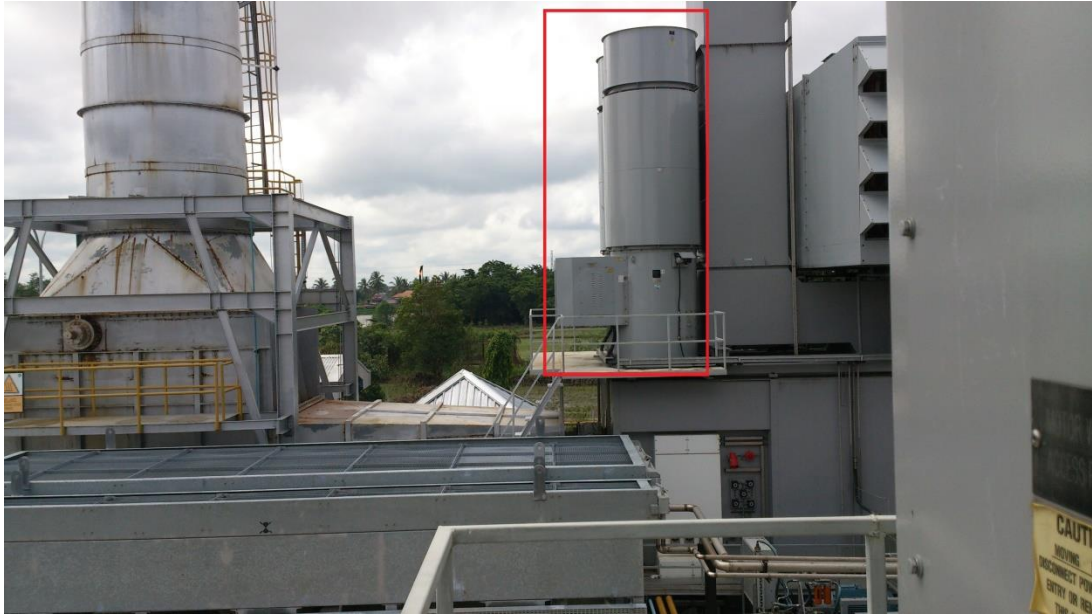
Gambar 1 Turbine Enclosure Fan (kotak merah)
