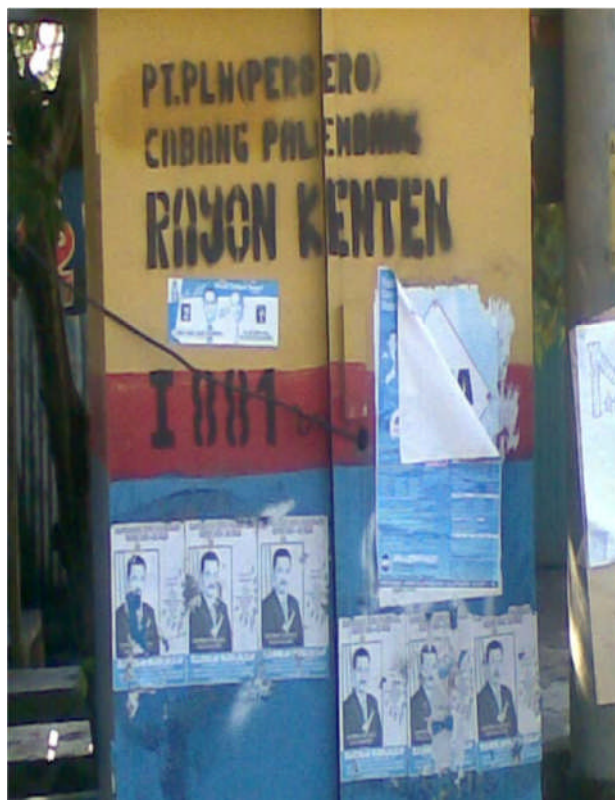
Gambar 2.10 Papan Hubung Bagi Tegangan Rendah
