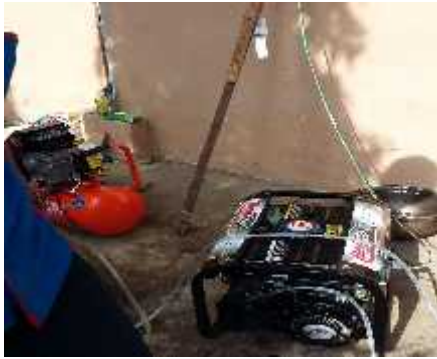
Pengujian Beban Listrik
