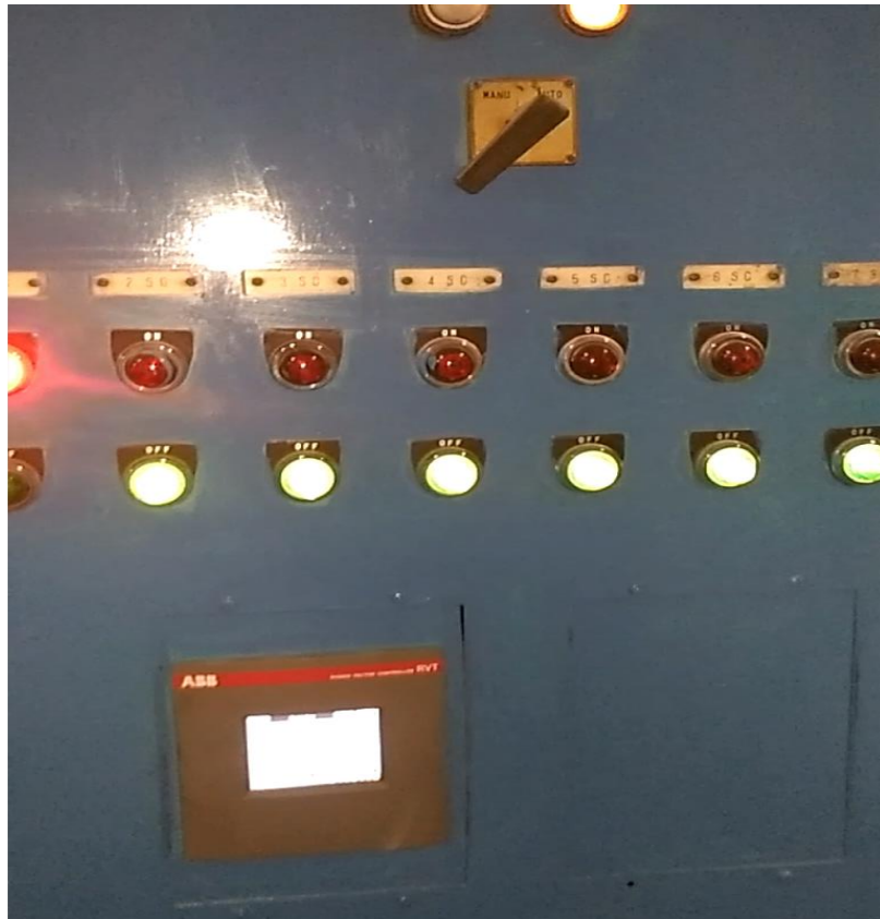
Lampu Indikator dan RVT Pada Pintu Panel Kapasitor Bank
