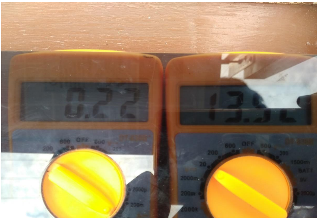
Pengujian Daya yang Di serap Panel Surya
