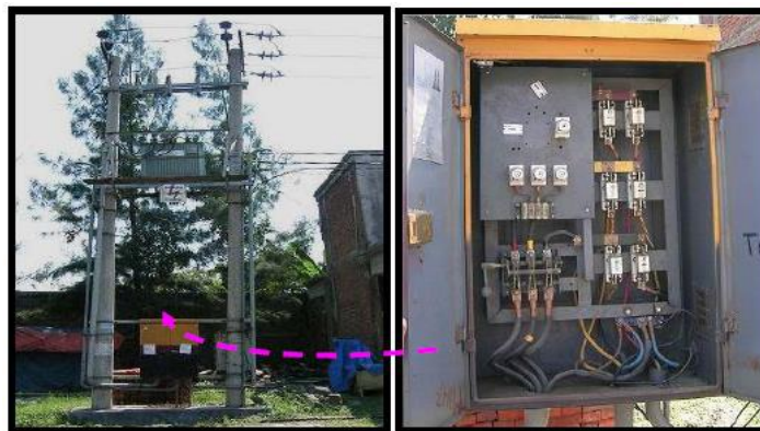
Gambar 2.9 Gardu Tiang Tipe Portal dan Midel Panel
