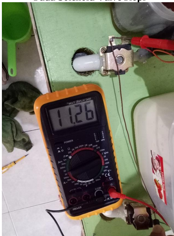
Gambar Pengukuran Tegangan Solenoid Valve Pada Minuman Teh Susu Pada Solenoid Valve Teh
