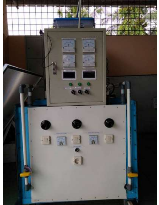
Gambar Panel Pengukur RPM, Arus, dan Tegangan Listrik Digital
