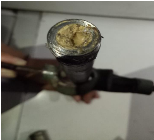
Penyumbatan pada tub
