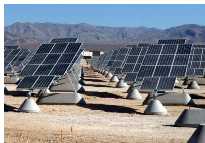
Gambar 2.1 Pembangkit Listrik Tenaga Surya
