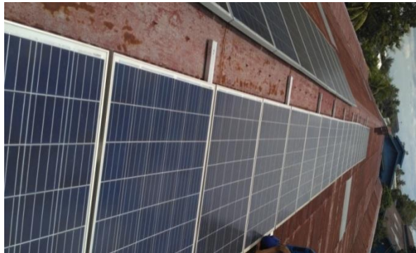
Gambar 2.1 Pembangkit listrik tenaga surya di Gedung Administrasi PT. PLN Keramasan
