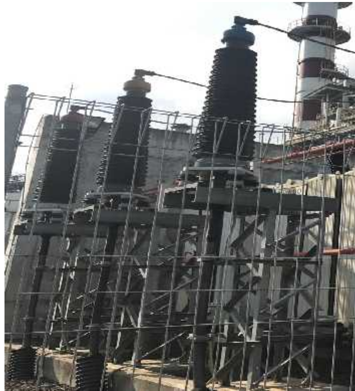
Gambar 3.3 Lightning arrester pada transformator daya 54 MVA
