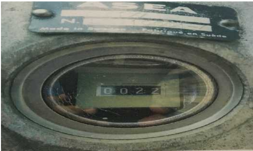
Gambar 3.4 Counter lightning arrester pada transformator daya 54 MVA
