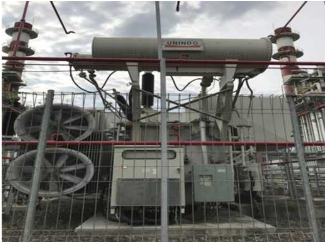
Gambar 3.1 Transformator daya 54 MVA pada pusat listrik keramasan
