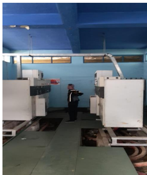
Gambar 2.12 Kondisi Gadu Hubung 7 sel kubikel tegangan menengah.
