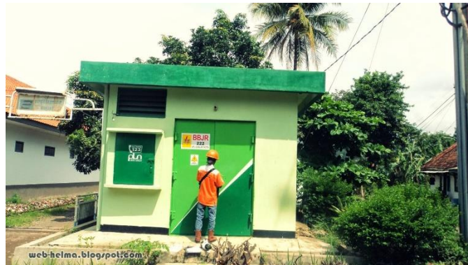
Gambar 2.6 Gardu Tipe Beton
