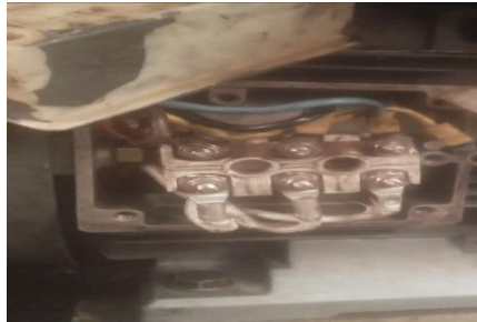
Gambar 2.18. Terminal pada motor
