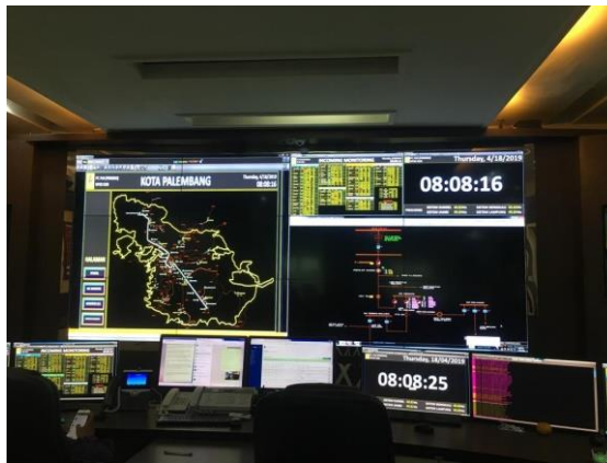
Gambar 2.9 Layar HMI di ruang SCADA Kantor PLN UP2D WS2JB
