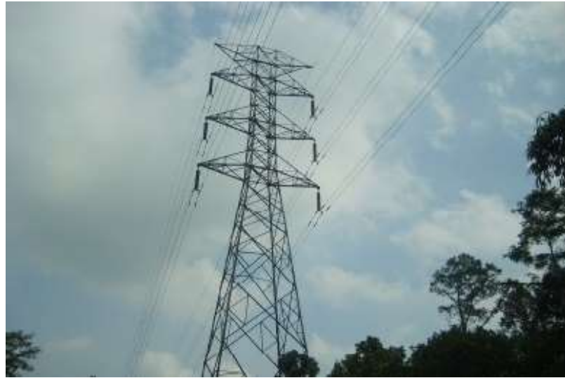
Gambar 2.12 Saluran Udara Tegangan Tinggi
