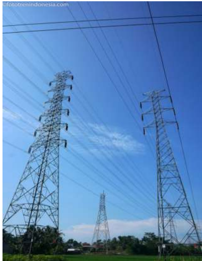
Gambar 2.11 Saluran Udara Tegangan Ekstra Tinggi
