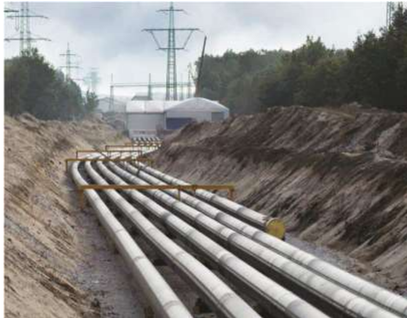
Gambar 2.10 Saluran Isolasi Gas Transmisi
