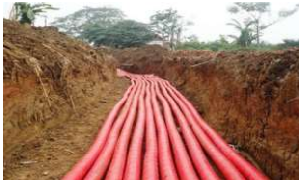
Gambar 2.8 Saluran Kabel Bawah Tanah Transmisi
