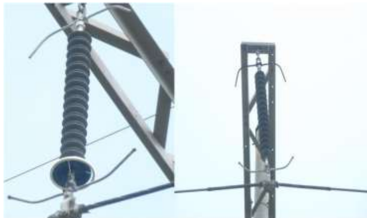
Gambar 2.21 Isolator Long Rod
