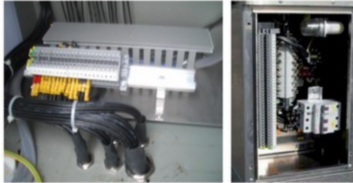
Gambar 2.14 Terminal dan Wiring Control
