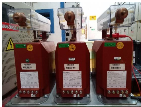
Gambar 2. 9 Trafo Tegangan/ PT/ CVT
