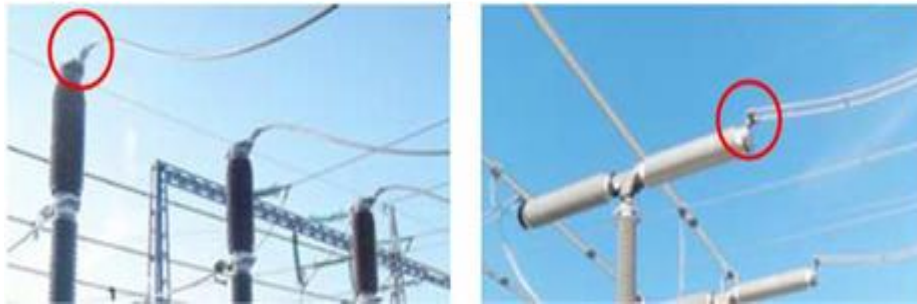
Gambar 2.9 Bagian Terminal Utama
