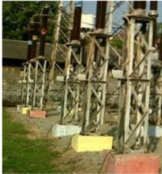
Gambar 2.16 Struktur Penyangga Lightning Arrester
