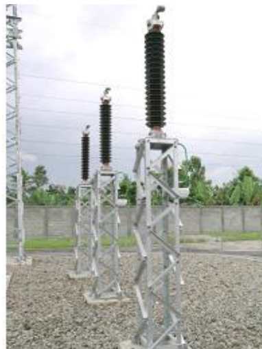
Gambar 2.20 Lightning Arrester pada Gardu Induk.
