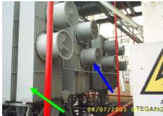
Gambar 2.7 Peralatan Bantu Pendinginan Transformator
